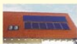
Instalacja 6-elementowa z kolektorami PV
