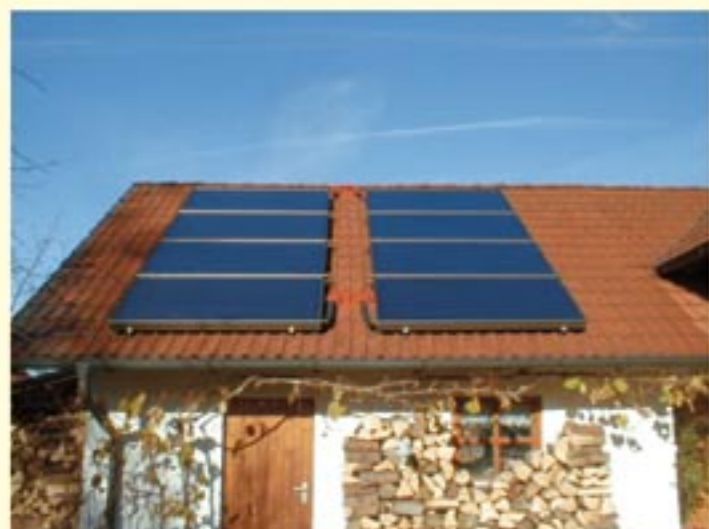
Poprzeczne ułożenie kolektorów słonecznych
