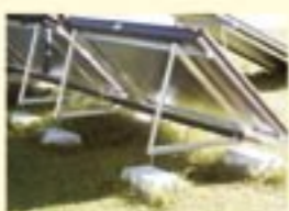
Swobodne rozmieszczenie kolektorów słonecznych
