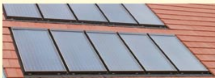
Instalacja 10-elementowa. Kolektory wbudowane na dachu
