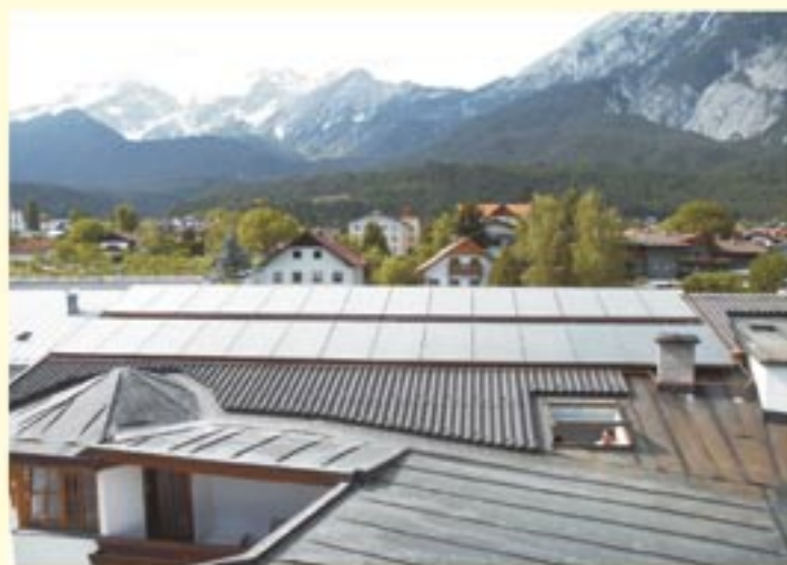
Instalacja z 28 kolektorów słonecznych na dachu hotelowym
